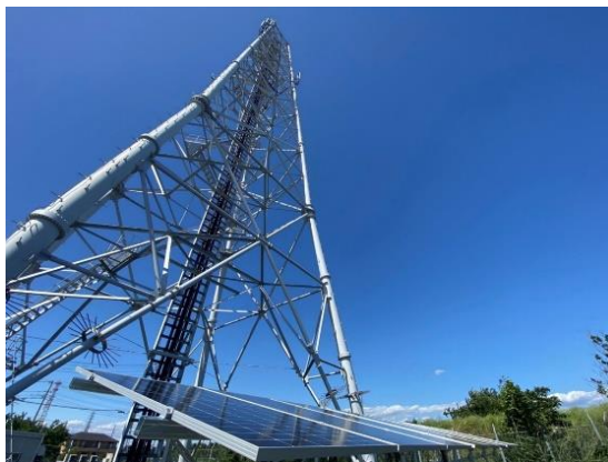
<サステナブル基地局>
