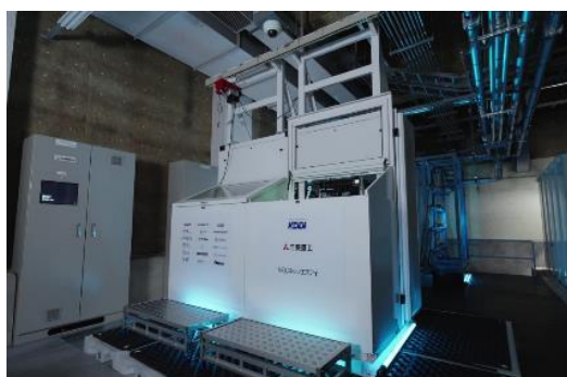
<液浸冷却装置>
