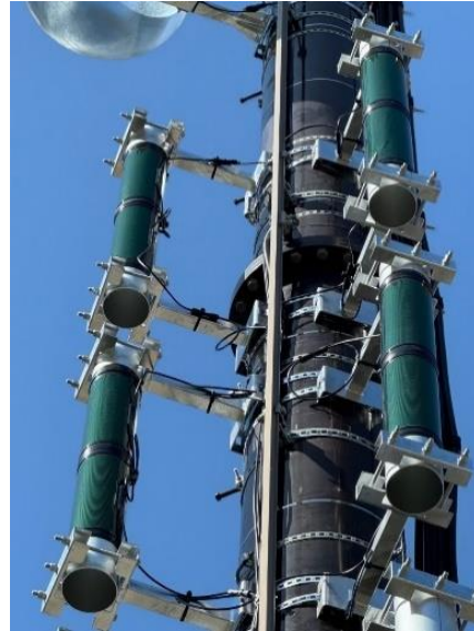
<ペロブスカイト太陽電池を設置した基地局>
